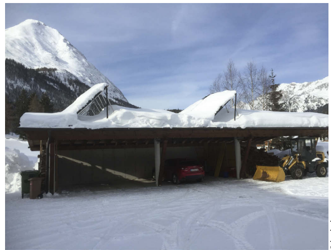
Abb. 7: PV-Module auf Garagendach in den Alpen.
